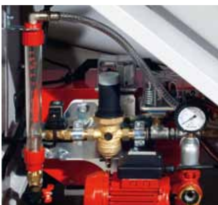
Instalación agua fácilmente accesible
